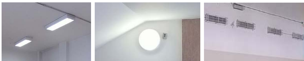
Figura 4.14 - Particolare dei corpi illuminanti
