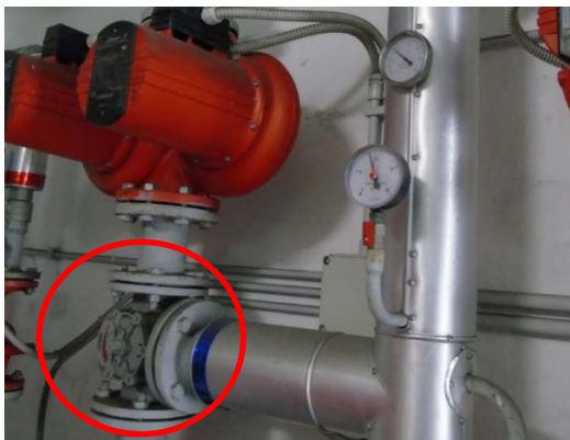
Figura 4.7 - Particolare della valvola miscelatrice
