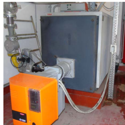
Figura 8.7 – Sistema di generazione obsoleto da sostituire
